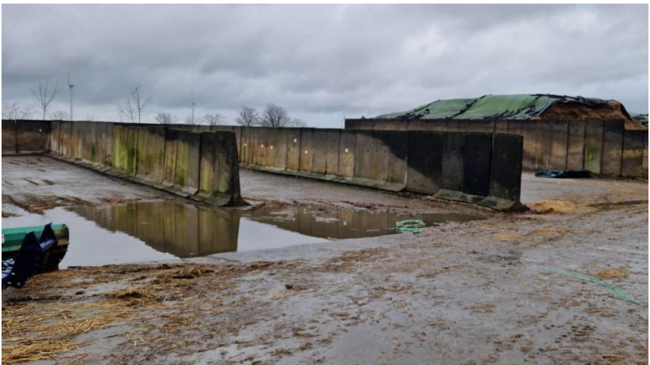
En cette saison, les trois silos devraient être remplis de pulpes de betteraves. Ils sont vides.
